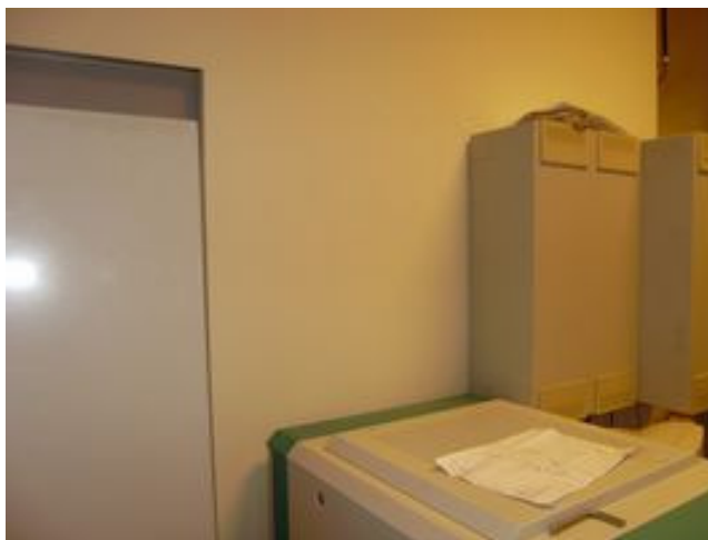
Spazio per ospitare il nuovo armadio da 42 unità rack
