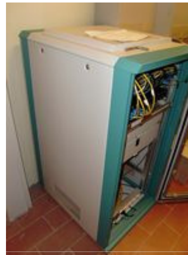
Armadio esistente da sostituire (particolare)
